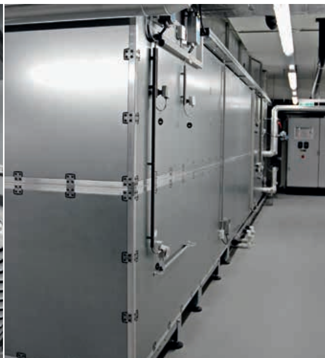
Anschlussseite eines RLT-Gerätes im Technikraum des LKH Bludenz (Revisionsseite gegenüberliegend).
