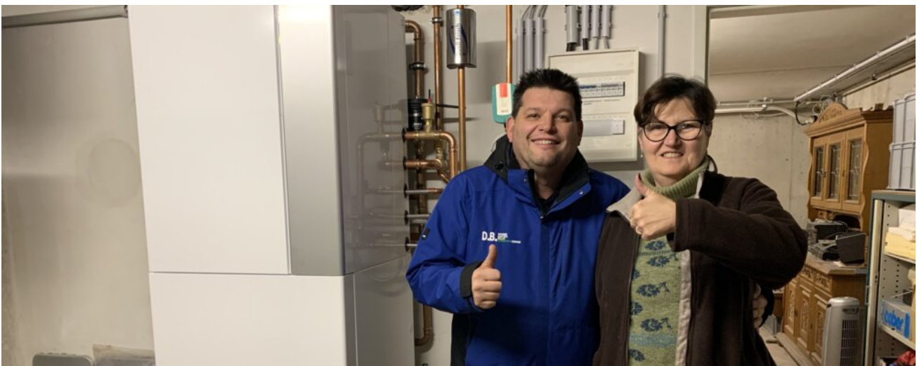
Sowohl vom Installateur als auch von der Betreiberin gibt es ein „Daumen hoch“ für die SPLITBLOCK Wärmepumpe von bösch.
