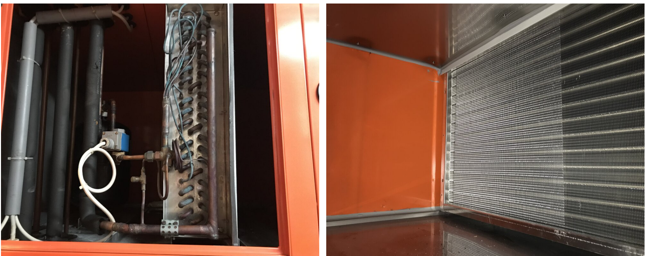
Statt mit Kältemittel betriebene Direktverdampfer (links) sind nun energiesparende und umweltschonende, weil mit wasserbetriebene, Kühlregister im Einsatz
