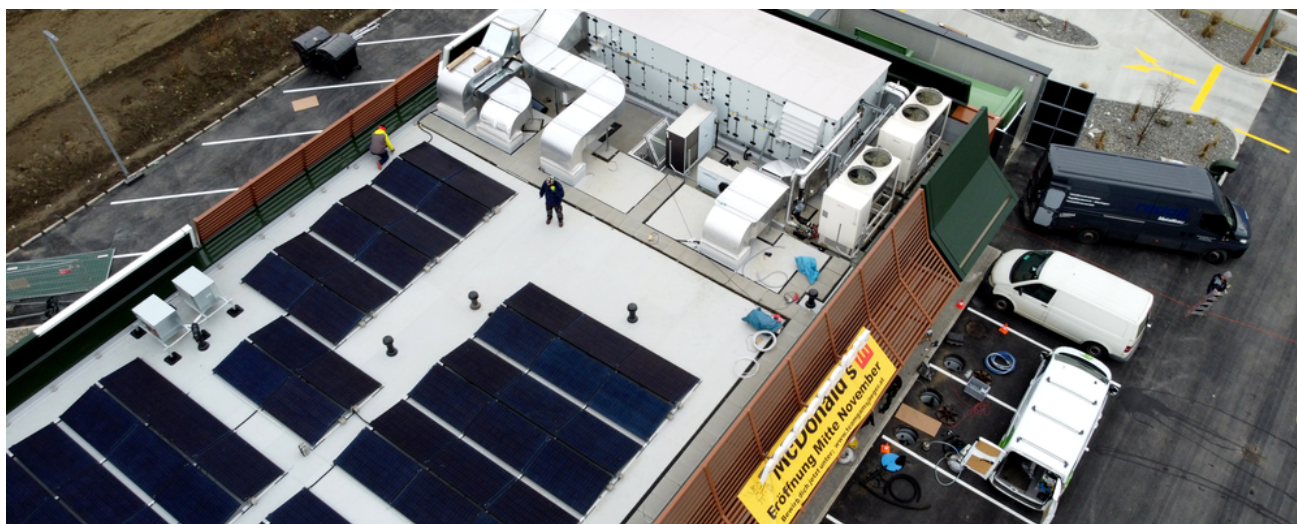
Die Gebäudetechnik (bösch All-in-one Kompaktlüftungsgerät, Wärmepumpen Clivet WSAN-YES und ein Samsung Klimagerät) sind auf dem Dach des Gebäudes positioniert.
