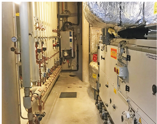
Rechts: Eines der Lüftungsgeräte für den Wellnessbereich für den Niederhof im Genusssdorf Gmachl.
