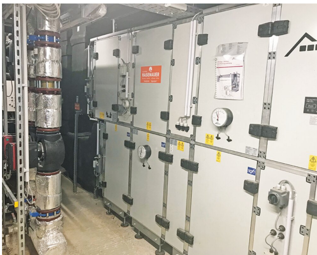
Links: RLT-Anlage für den Hang-Spa im Genusssdorf Gmachl.
