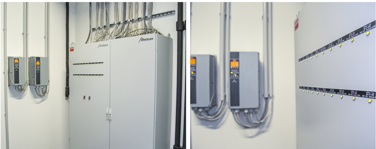
Schaltschrank mit DEOS OPENweb-Regelung. Moderne Regelungstechnik von bösch im prämierten Blue Building von Peter Blau.
