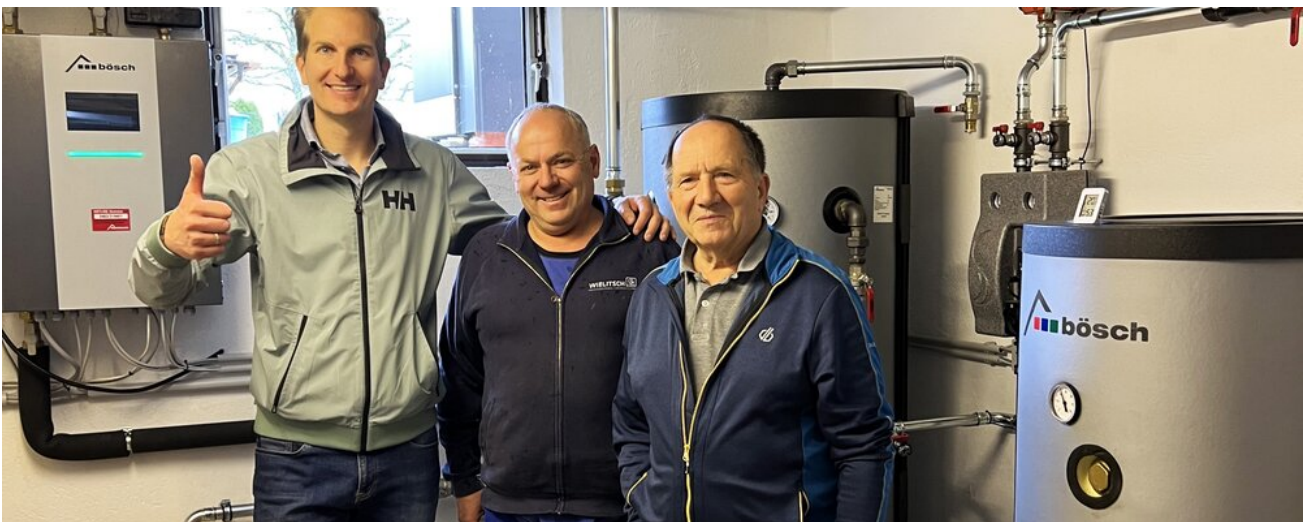
Der Hausbesitzer freut sich gemeinsam mit dem Installateur GKV Haustechnik und bösch Verkaufsleiter Stefan Verhounig über die erfolgreiche Inbetriebnahme der neuen Wärmepumpenlösung.
